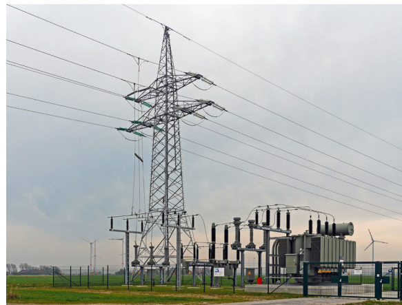
Fig. 3. Poste eléctrico de alto voltaje y transformador
