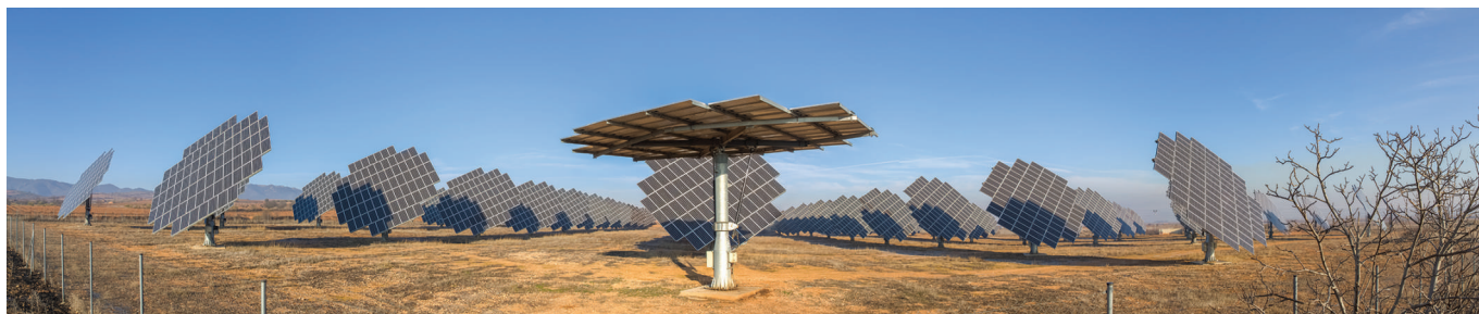
Estación solar fotovoltaica de Cariñena, provincia de Zaragoza, España
